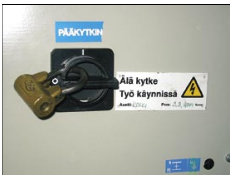
Kuva 18. Lukittu ja merkitty pääkytkin
