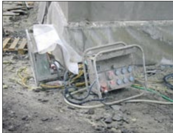
Kuva 13. Tilapäiset sähköasennukset työmaa-olosuhteissa.
